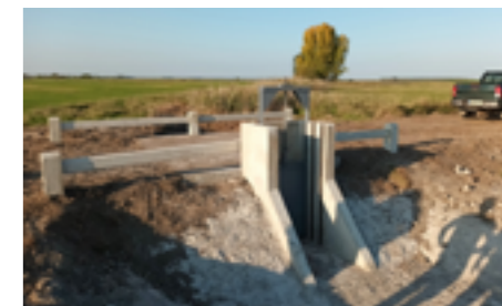
A földutat keresztező zsilipes átterest a vízelvezetés, illetve vízmeztartás szabályozására szolgál. Fotó: Pataki Zsolt
